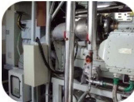
Particolare del cogeneratore
