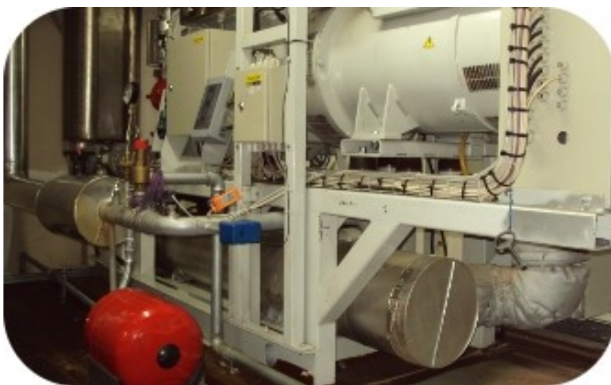
Unità di cogenerazione da 160 kWe e 199 kWt, TEDOM mod. Cento T160 SP
