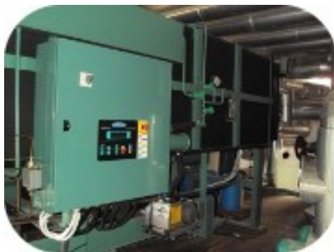
Unità di assorbimento a bromuro di litio
