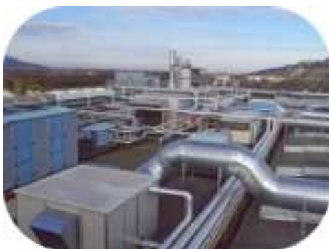
Linee di distribuzione acqua calda e refrigerata
