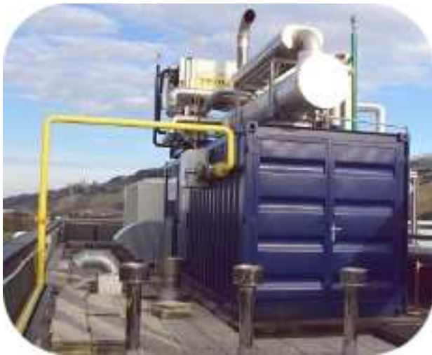
Unità di trigenerazione in versione container da 300 kWe
